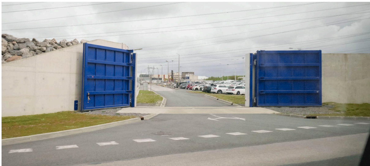
↑ Figure 7 : Les portes étanches permettant d’isoler les parkings attenants à la centrale nucléaire de Gravelines en cas de submersion marine ou d’inondation par les terres. @Greenpeace, 2024
