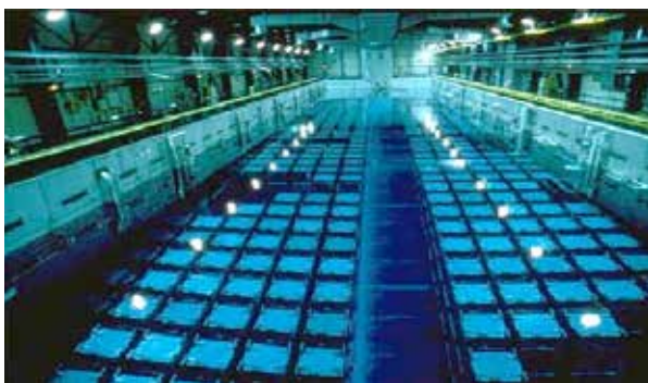
Figure 1 – Grand bassin d'entreposage des combustibles irradiés à La Hague
